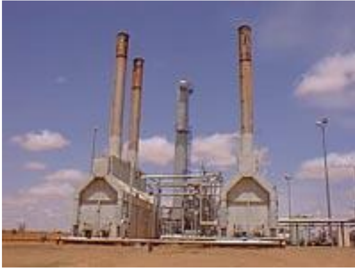
صورة لمحطة إنتاج الغاز
