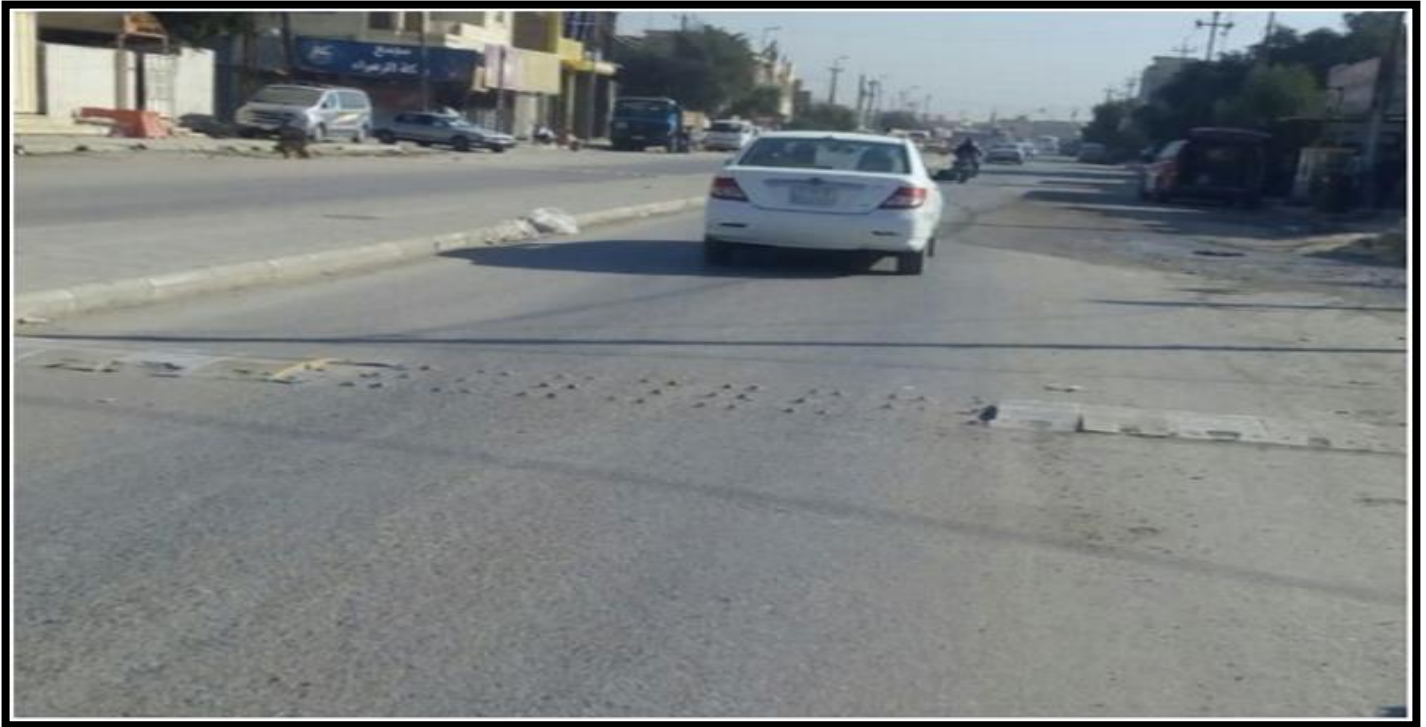
الشكل يوضح تآكل المطب البلاستيكي
